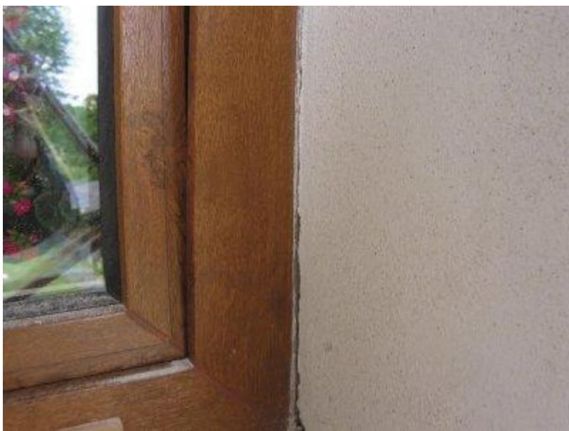
Trhlina vzniklá mezi oknem a omítkou
